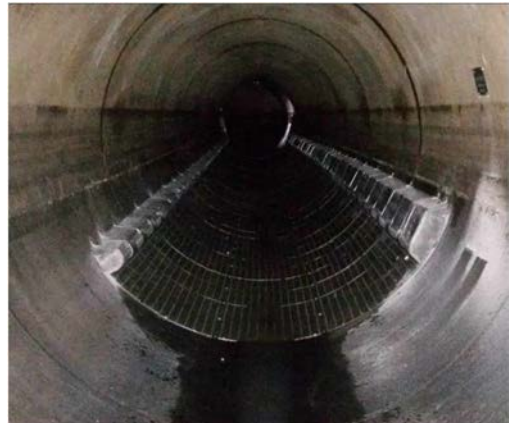
Abb. 32: Abwasserwärmetauscher im Kanal [UHRIG]
